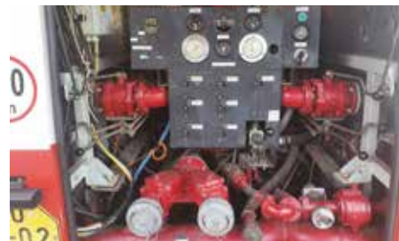
Stav před opravou
